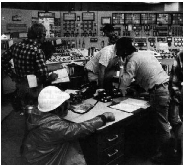
Figuur 1 Controlekamer TMI-2 tijdens de afhandeling van de storing (Kemeny, 1979)
