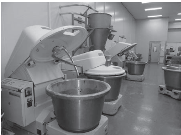
Figuur 1 Voor installatie afzuiging
